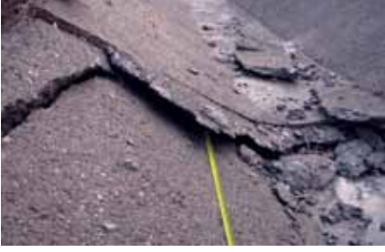
Van Yüzcüncü Yıl Üniversitesi kuzeyindeki bir sulama kanalında sıkışma sonucu gelişmiş deformasyon
