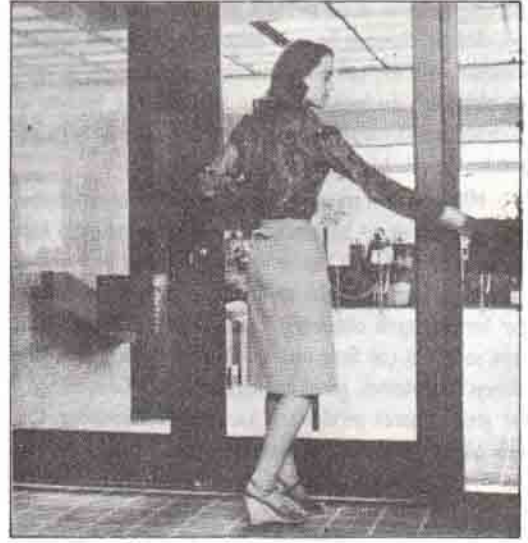
Elektronik giriş kontrollü bir kapıya yerleştirilmiş kart algılayıcısı.
