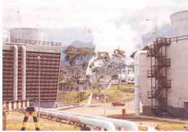
El Salvador'da Ahuachapán jeotermal santralının soğutma kuleleri
