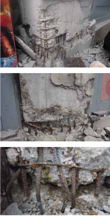
Şekil 3. Bina iç ve dış hasar görüntüleri
