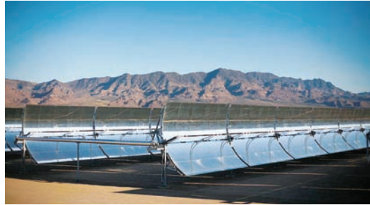
Nevada Solar One, 64 MW'lık parabolik çizgisel odaklayıcı sistem.
